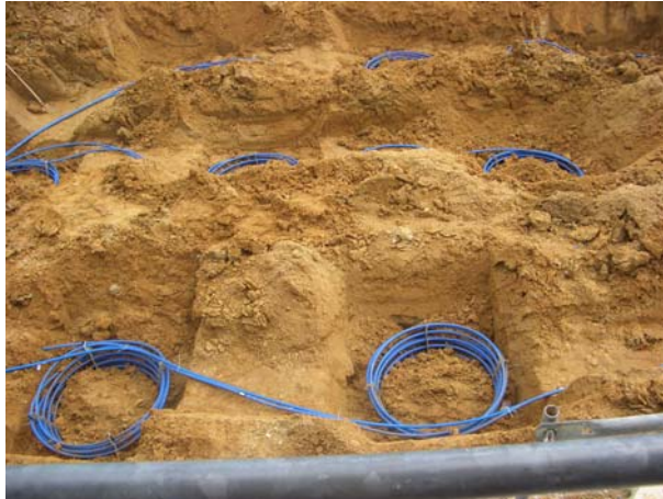
Bild einer angeschlossener 9- Korb Anlage
